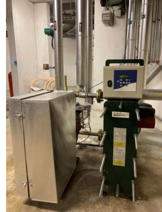
Photo: Josée Thollet / Cetetherm
